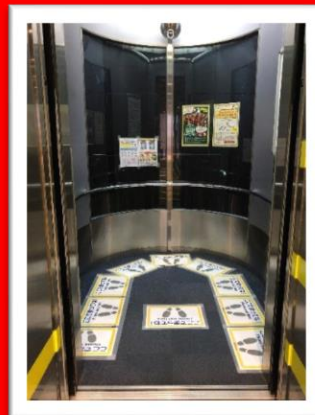
エレベーター
